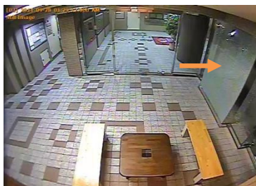
中央:破損した状態
